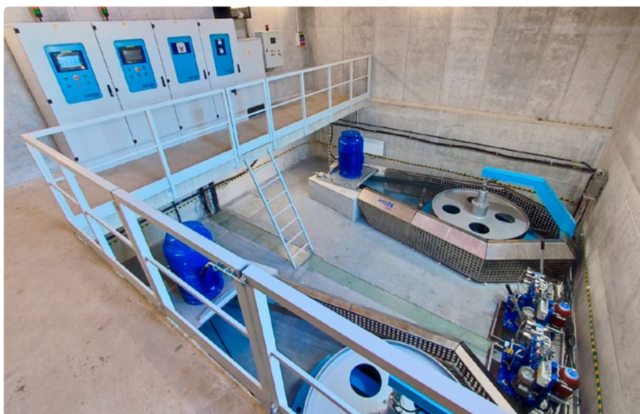
Fot. 4. Wnętrze MEW z dwoma hydrozespołami i podestem sterowniczym
