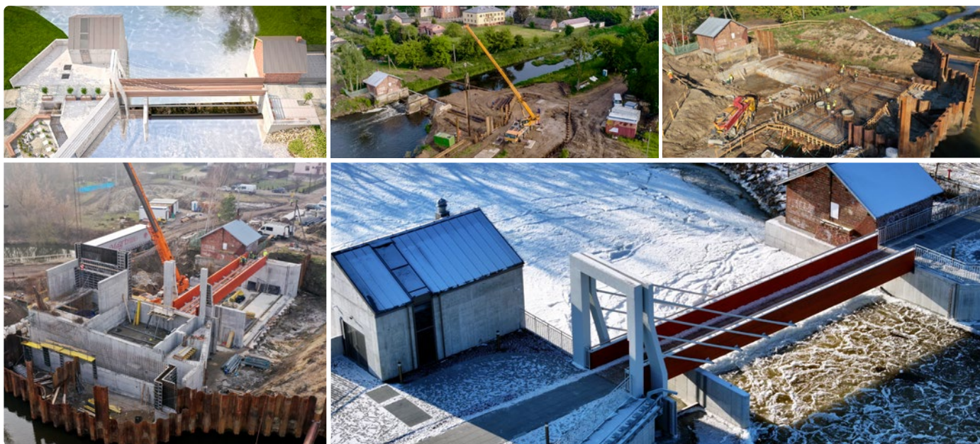
Fot. 5. Przebieg inwestycji w Makowie Mazowieckim - od koncepcji, poprzez poszczególne etapy prac budowlanych po efekt końcowy
