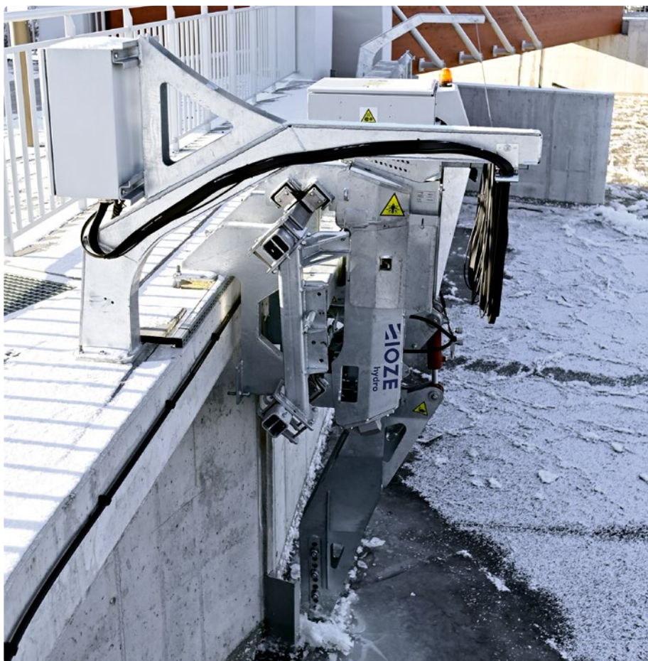
Fot. 6. Czyszczarka krat poziomych wspomagająca pracę obiektu
