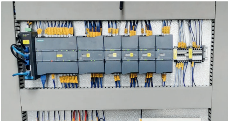
Fot. 5. Widok wnętrza szafy sterowniczej
