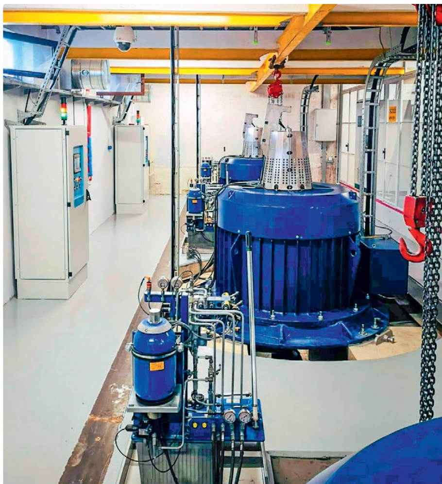
Fot. 6. Wnętrze obiektu po repoweringu
