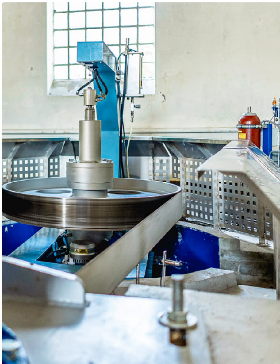
Fot. 4. Jeden z dwóch nowych układów prądowłórczych w MEW Niedalino
